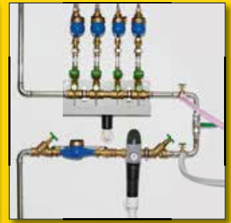
Spoelen van drinkwaterinstallaties (S/SL/SLW)
